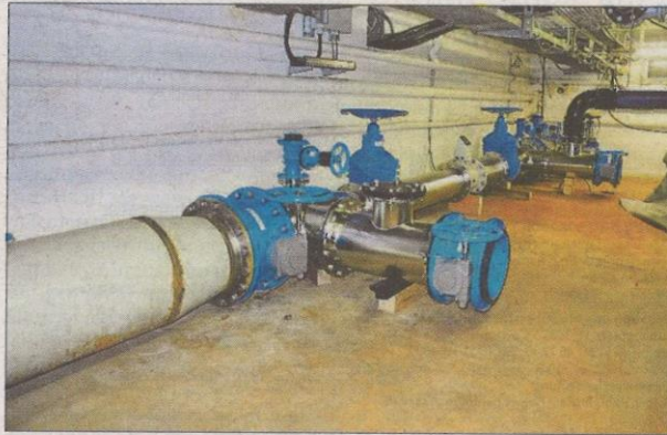
Die Leitung Richtung Garbsen im Keller des Wasserwerks Forst Esloh ist bereits teilerneuert worden.
