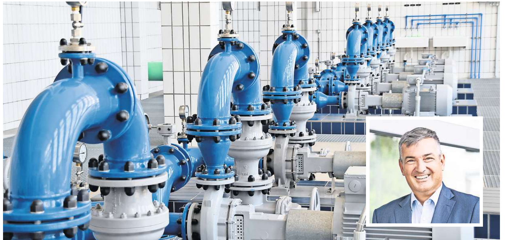
Mit diesen Pumpen wird das Trinkwasser ins Netz befördert. So sieht das Gelände des Wasserverbands Garbsen-Neustadt im Stadtteil Auf der Horst aus. Neustadts Stadtwerke-Chef Dieter Lindauer (kleines Bild) zeigt sich offen für neue Kooperationen. FOTO: GERKO NAUMANN (ARCHIV)
