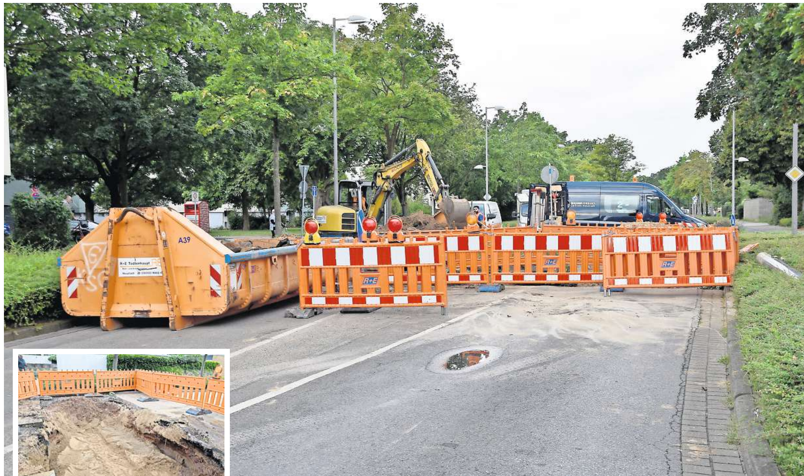
Die Straßendecke an der Ecke Auf der Horst/Saturnring muss nach dem Wasserrohrbruch vom Wochenende erneuert werden. Autofahrer müssen die Stelle umfahren.
