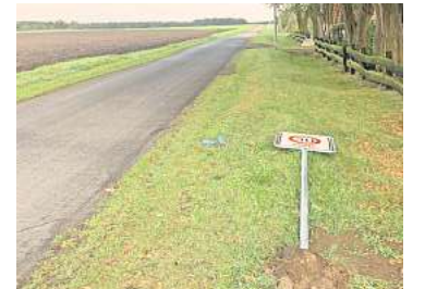
In Scharrel liegen kurz nach dem Aufstellen mehrere Tempo-30-Schilder auf dem Boden. FOTO: PRIVAT
