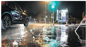
Leitung gebrochen: Das Wasser sprudelte durch alle Ritzen im Gehwegpflaster. FOTO: MARKUS HOLZ
